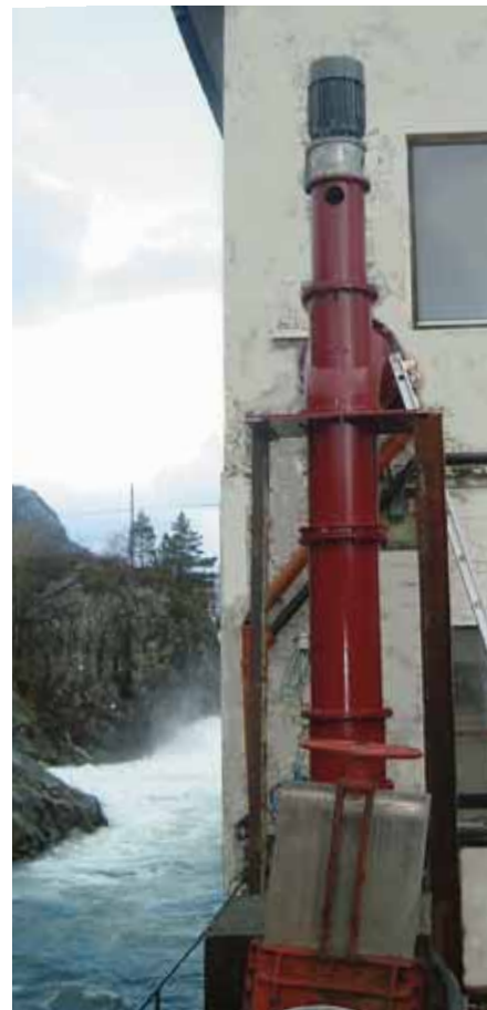
Propellpumpe flytter inntil 18m 3 /min til klekkeri i 2. etasje, Severeid Fiskeanlegg
